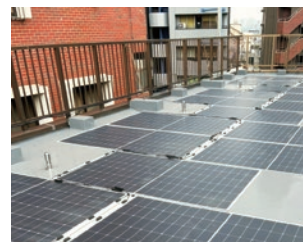
▲ご自宅の屋上に設置
