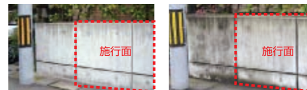
4年経過 6年5ヵ月経過 一般住宅コンクリート塀の例。6年5ヵ月経過時の写真は雨上がりに撮影したもので、水分を含んでいるものの、施工・未施工部の違いは明らか。
